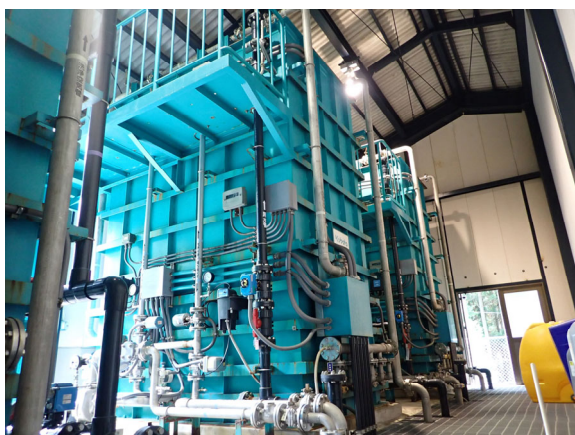
写真：膜ろ過設備（上里浄水場）
