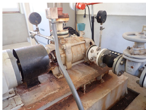
写真：老朽化設備
