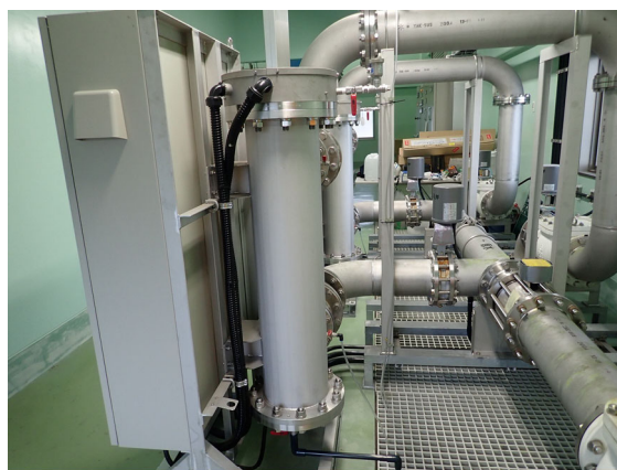
写真：紫外線照射設備（池田浄水場）
