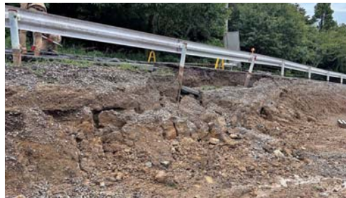
西田道路の被災状況(写真提供:県土整備局)
