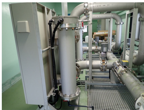
写真：紫外線照射設備（池田浄水場）
