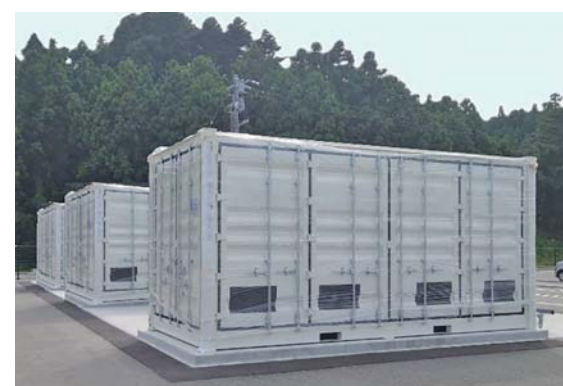
▲11月に稼働開始するバイオマス発電所
