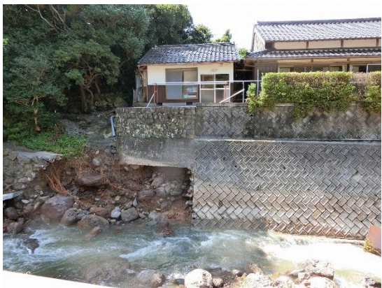
油井川 ブロック積擁壁崩落
