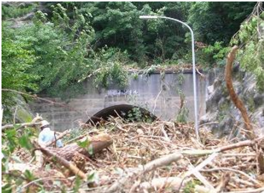
唐尾トンネル上部の谷からの土砂及び立木の流出状況(隠岐の島町加茂地内)
