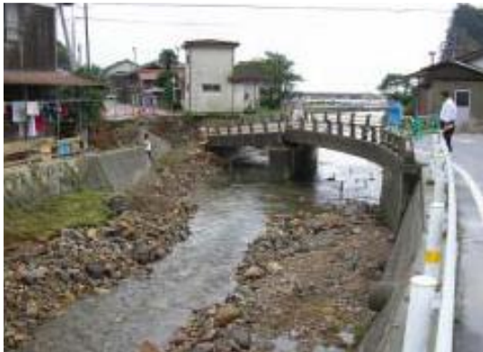
大久川の洪水により寺空橋が落橋
