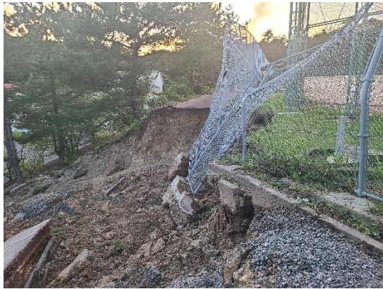
町民グラウンド法面崩落(五箇地区)
