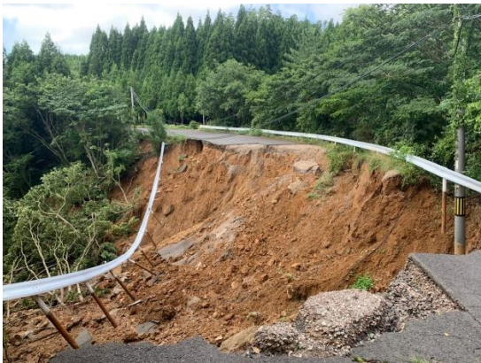
久見20号線道路崩落(五箇地区)
