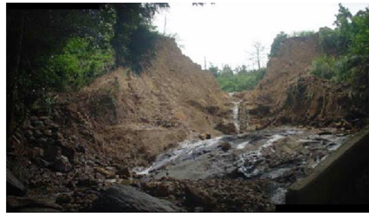
ため池堤体崩壊(隠岐の島町西田地内)
