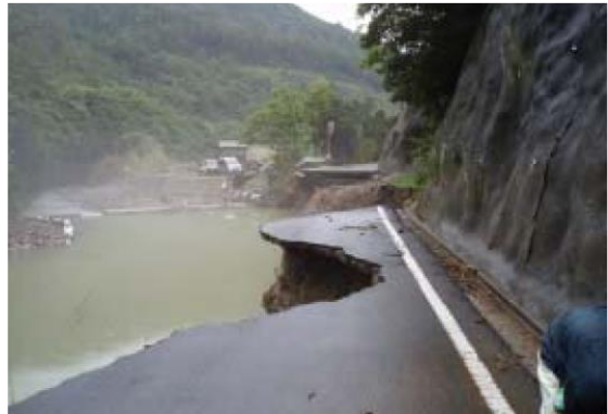
末路川の氾濫により道路が流出した一般県道 中村津戸港線(おぼみ橋付近)
