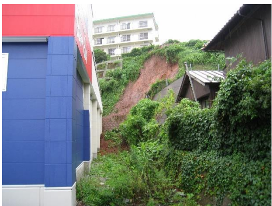
商業施設裏法面崩落(隠岐の島町西町地内)
