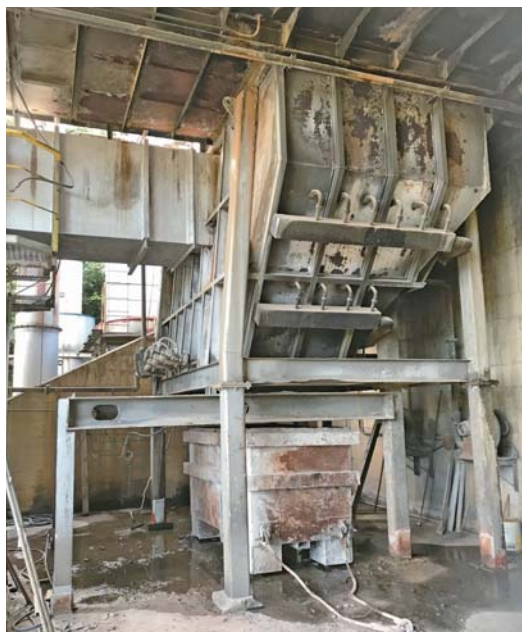
補修が急がれる焼却炉
