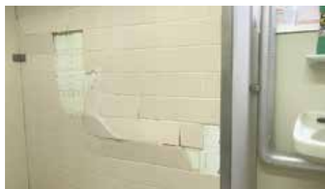
有木小学校 体育館トイレ タイル壁はく離
