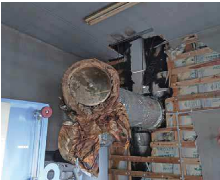
火災があったペレットボイラー室
