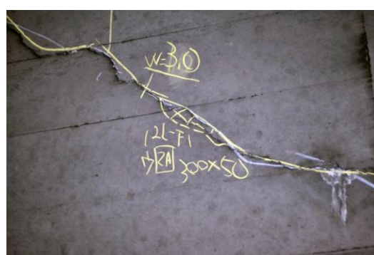
覆工アーチ部のひび割れ
