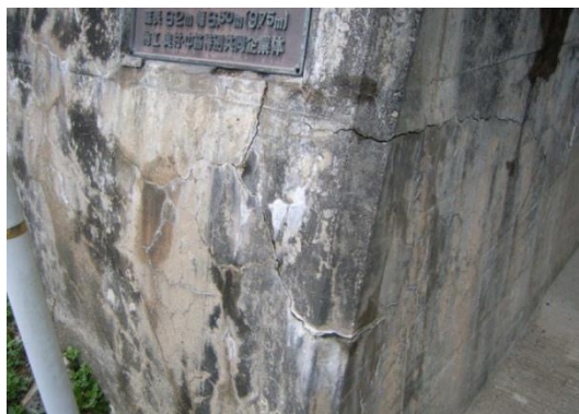
抗門面壁のひび割れ
