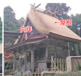
下西地区 玉若酢命神社（隠岐造） 屋根と向拝がつながっていない。
