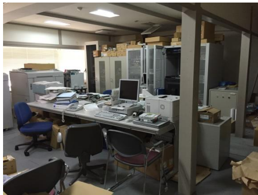
会議室を改造したサーバー室
