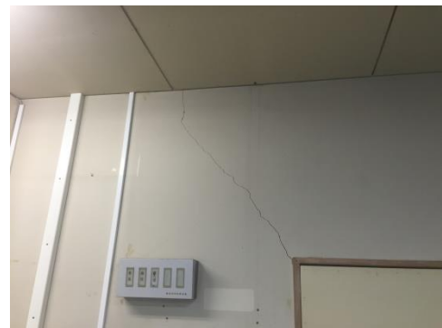
壁に入ったクラック
