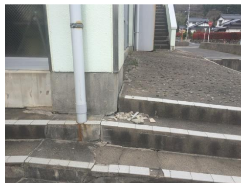
周辺の地盤沈下
