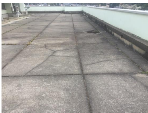
老朽化した屋上
