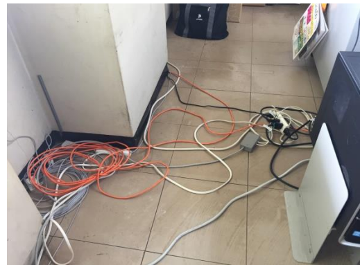
配線が露出しているフロア
