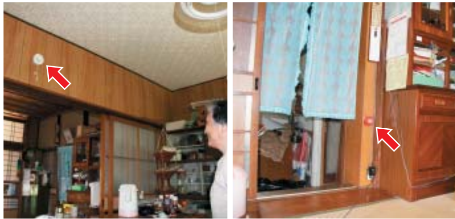
台所には火災警報器が設置されています
