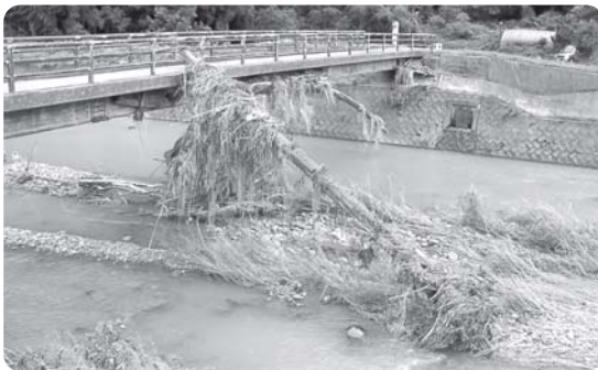
流木がひかかった橋
