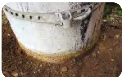
腐食した鉄柱
