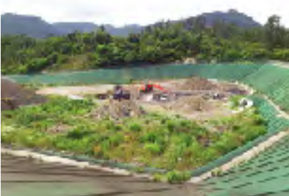
埋め立て施設
