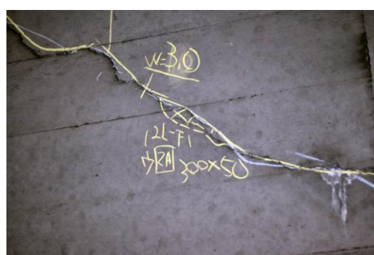
覆工アーチ部のひび割れ
