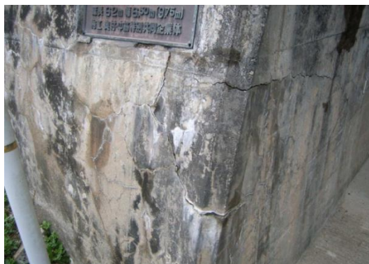
抗門面壁のひび割れ
