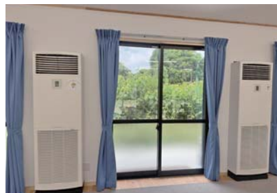
▲整備したエアコンの一部
