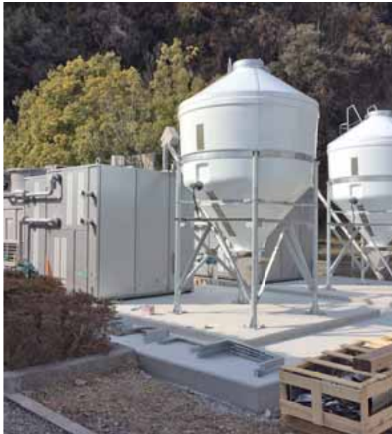
図書館に整備されたペレットボイラー
