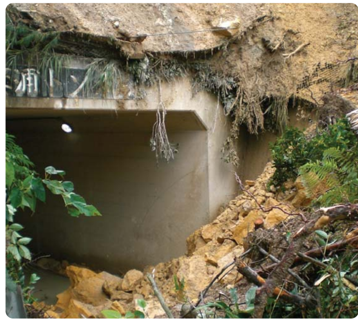
箕浦道路の災害現場
